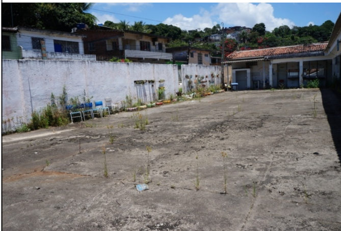
FOTO 01- Recuperação do piso cimentado. – refazer com aproveitamento do material a ser quebrado como base para novo piso.
