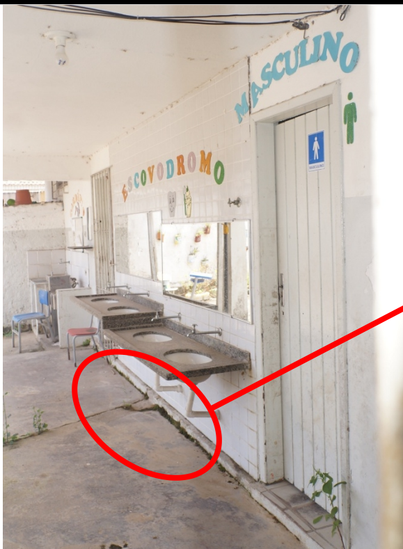
FOTO 23 - Recuperação do piso cimentado. – refazer com aproveitamento do material a ser quebrado como base para novo piso.
