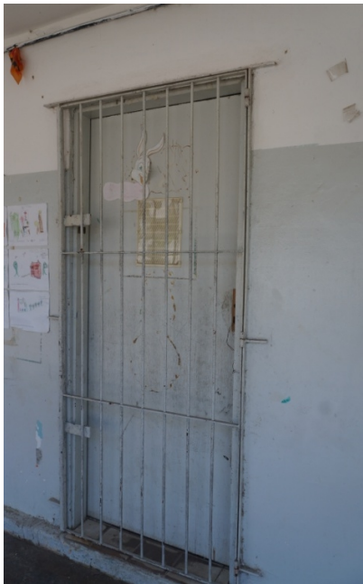
FOTO 09 – Substituição de porta em madeira, inclusive ferragens e fechadura e recuperação da grade com raspagem e pintura.
