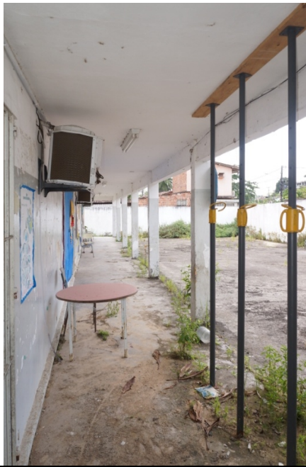
FOTO 13 - Recuperação estrutural do pilar com aplicação de graute, inclusive da base, com retirada do material desagregado, lixamento da ferragem, proteção da ferragem com primer e recomposição da ferragem quando necessário.
