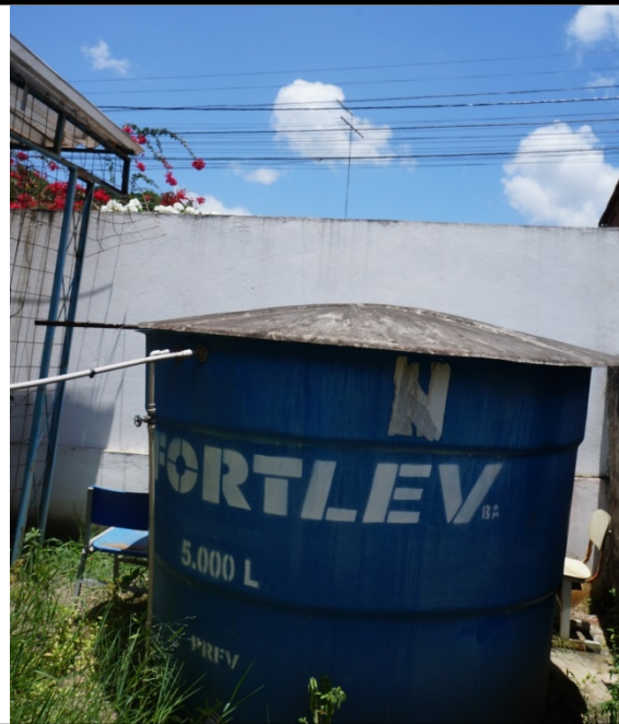
FOTO 16 - Construção de estrutura para caixa de água de 5.000l em concreto com 4 pilares, base elevada em concreto, escada de acesso e fechamento em alvenaria com porta para depósito com piso em concreto.
