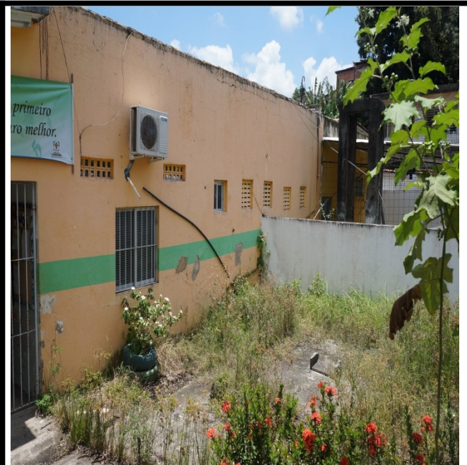
FOTO 44 – Retirada do reboco com aplicação de novo reboco - após colocar cerâmica a meia parede inferior (1,7m) na cor branco gelo e pintura em tinta látex na meia parede superior.
