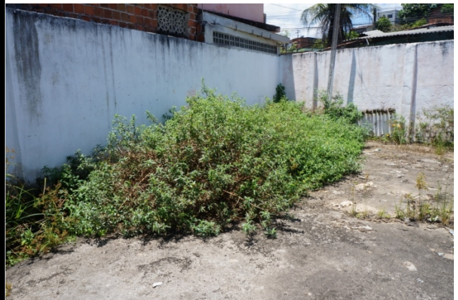
FOTO 02- limpeza e refazer a canaleta de drenagem da água pluvial e de percolação e extravasamento da galeria de esgoto que circunda a escola.
