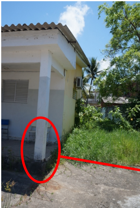
FOTO 05 – Recuperação estrutural do pilar com aplicação de graute, inclusive da base, com retirada do material desagregado, lixamento da ferragem, proteção da ferragem com primer e recomposição da ferragem quando necessário.
