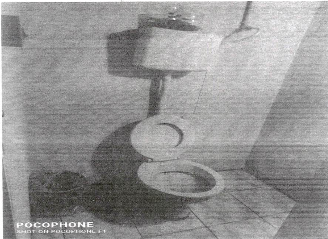
BANHEIRO DOS USUÁRIOS, SEM REVESTIMENTO CERÂMICO DAS PAREDES E SEM AS PEÇAS BÁSICAS PARA FUNCIONAMENTO.
