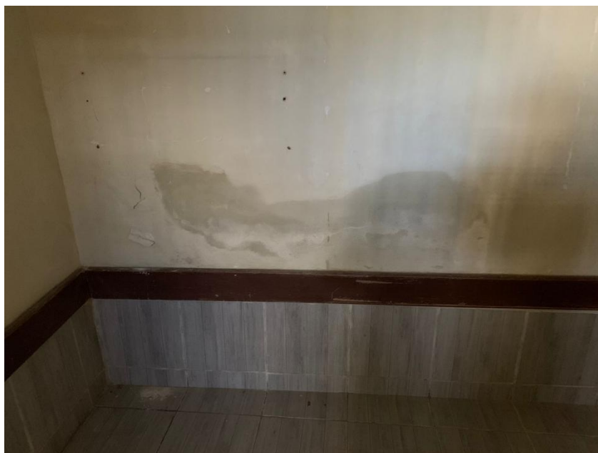
Figura 14 – Paredes apresentando sinais de infiltração no pavimento superior. Fonte: Prefeitura Municipal de Camaragibe, 2023.
