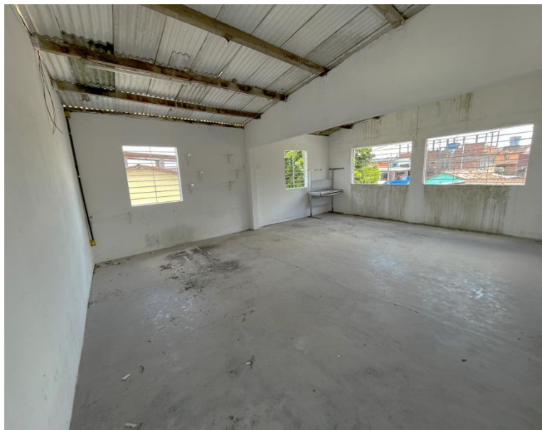
Figura 3 – Paredes com marcas de infiltração. Fonte: Prefeitura Municipal de Camaragibe, 2023.
