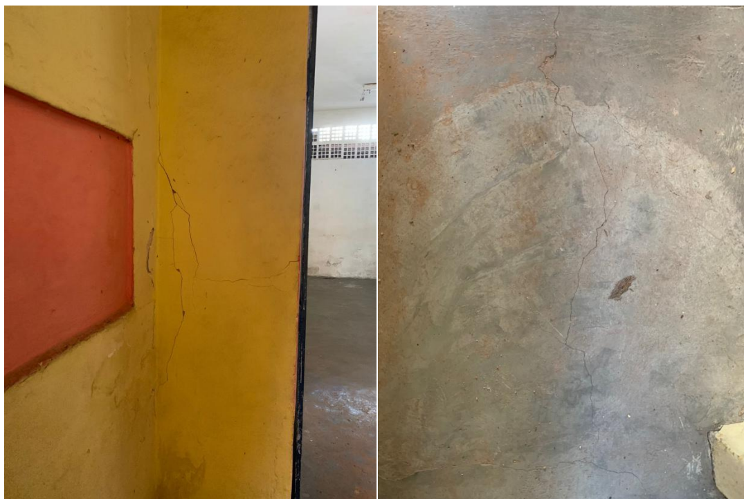
Figuras 12 e 13 – Paredes e piso do pavimento superior apresentando rachaduras. Fonte: Prefeitura Municipal de Camaragibe, 2023.
