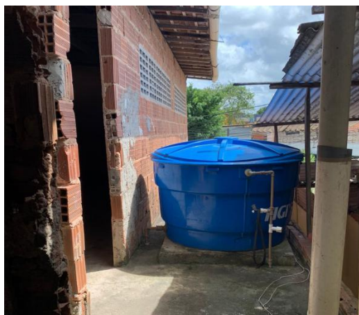
Figura 8 – Caixa d'água sobre piso. Fonte: Prefeitura Municipal de
