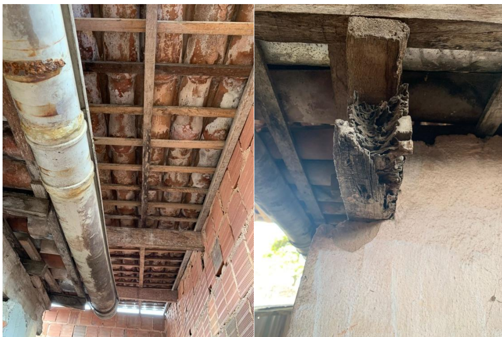
Figuras 5 e 6 – Pontos de umidade no telhado. Fonte: Prefeitura Municipal de Camaragibe, 2023.
