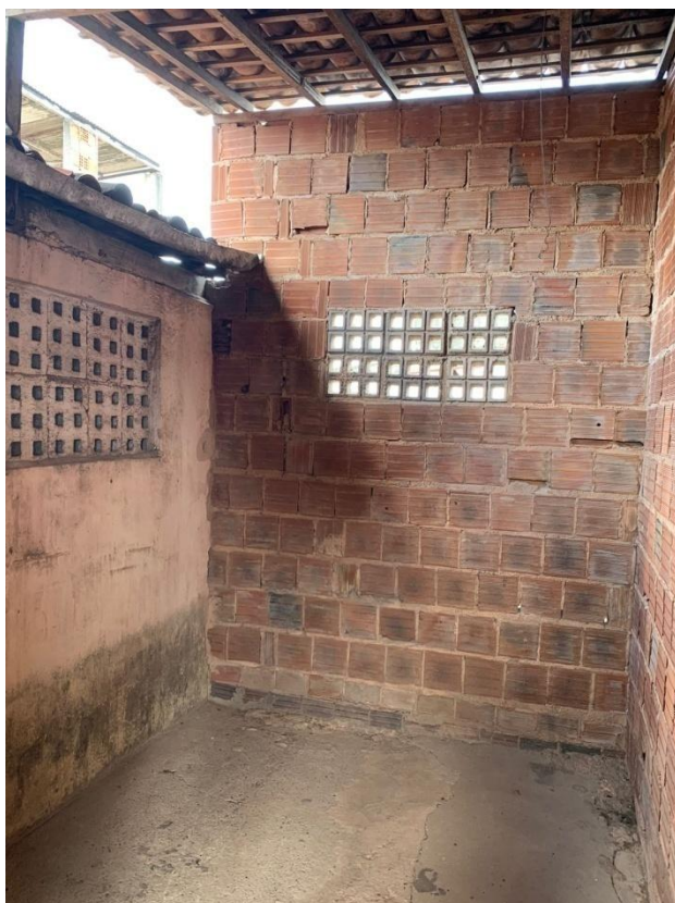
Figura 4 – Paredes e piso sem revestimento. Fonte: Prefeitura Municipal de Camaragibe, 2023.
